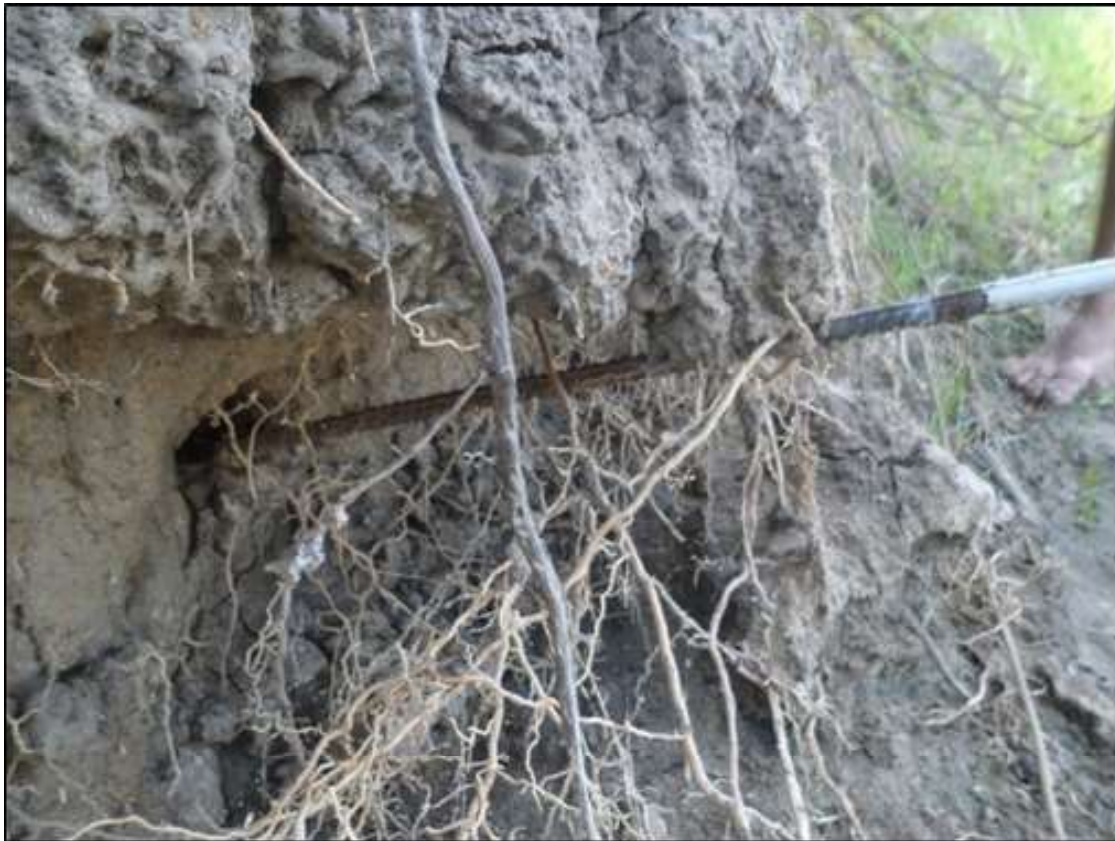
Figura 8 - Pino exposto decorrente da ação da erosão fluvial (Seção Sucurujuba I).
