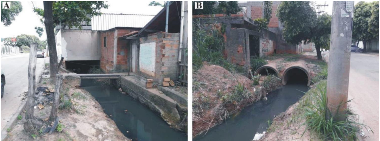
Figura 8. Aspecto do leito do Rio São Jacinto. Note as passarelas rudimentares de madeira que ligam a rua às residências e a casa construída sobre o canal (A), como também a canalização precária, parcialmente entulhada por sedimentos e lixo (B).
