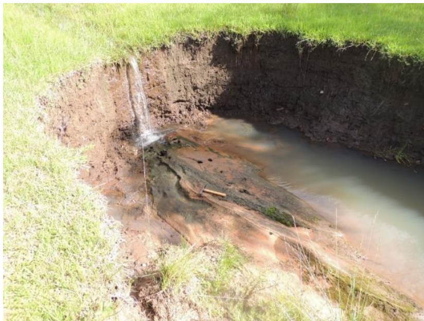
Figura 17. Interior da ravina, expondo um valão em processo de entalhamento. Observa-se que a camada de depósitos sobre a rocha é pouco espessa, com cerca de 45 cm, acima da Formação Botucatu. Bacia Hidrográfica do Arroio Miracatu, RS. Fonte: acervo pessoal dos autores (janeiro de 2017).
