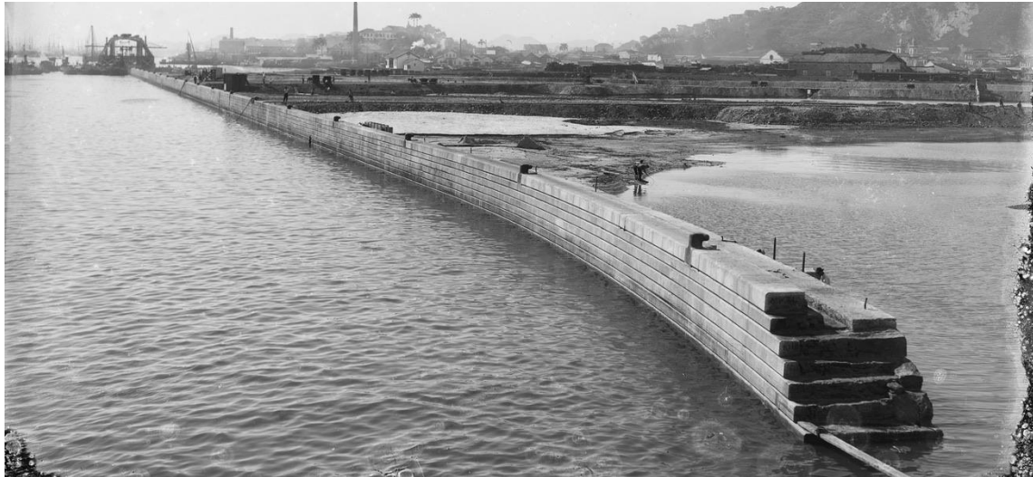
Figura 17. Construção do Porto do Rio de Janeiro em 1906, trecho do bairro da Gamboa. Primeiro foram construídos longos espigões de enrocamento, e sobre eles foi erguido este espesso muro de matações rochosos cortados em forma de paralelepípedo. O muro serviu de barragem para o aterro que foi preenchido, primeiro, com areia marinha, que serviu para aprofundar o leito para o porto. Posteriormente recebeu material do desmonte dos morros e entulho. Foto: Marc Ferrez (Pinheiro e Rabha, 2004).
