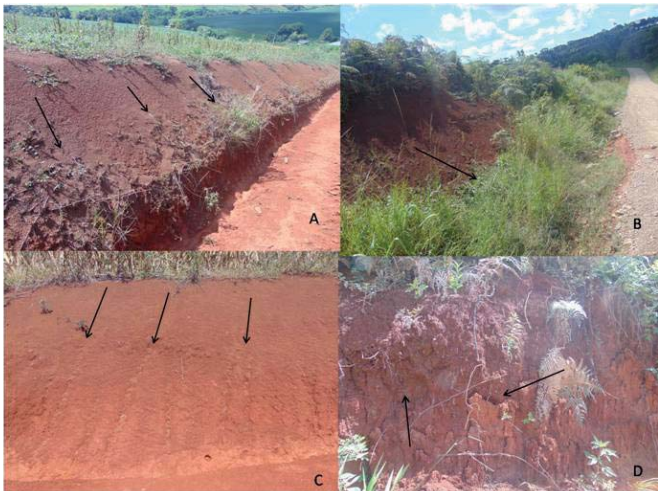
Figura 5 - A) início do processo de acúmulo de solo na parte inferior; B) regeneração da vegetação na parte inferior do barranco; C) ravinamento na parte superior do barranco > 2,5 metros de altura; D) barranco vertical com desmoronamento e solapamento devido ao ciclo da umidade.
