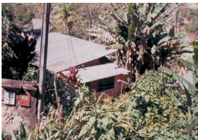
Figura 6: Casas sugeridas para remoção, devido a sua baixa qualidade estrutural, e a sua localização, em área de convergência de fluxos, de declividade elevada ( 46^\circ ) e de contato solo-rocha abrupto. Foto A.J.T. Guerra, 2005.
