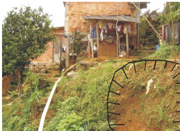
Figura 7 - Casas sugeridas para remoção, devido a sua baixa qualidade estrutural, e a sua localização, em área de convergência de fluxos, de declividade elevada ( 46^\circ ) e de contato solo-rocha abrupto. Foto A.J.T. Guerra, 2005.
